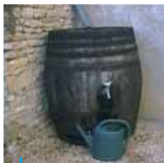
Citerne de récupération des eaux pluviales
