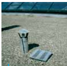
Dispositif de régulation, toiture stockante non végétalisée, Villeurbanne
