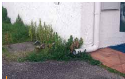
Evacuation des eaux de toitures, Chassieu
