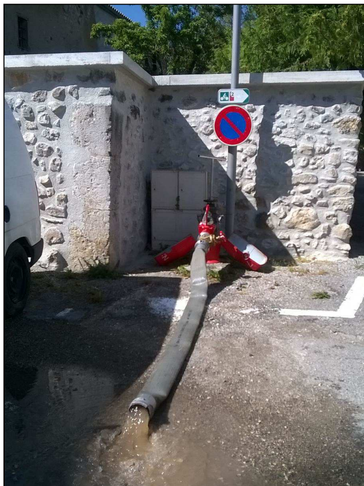
Mesure du poteau incendie n°07
