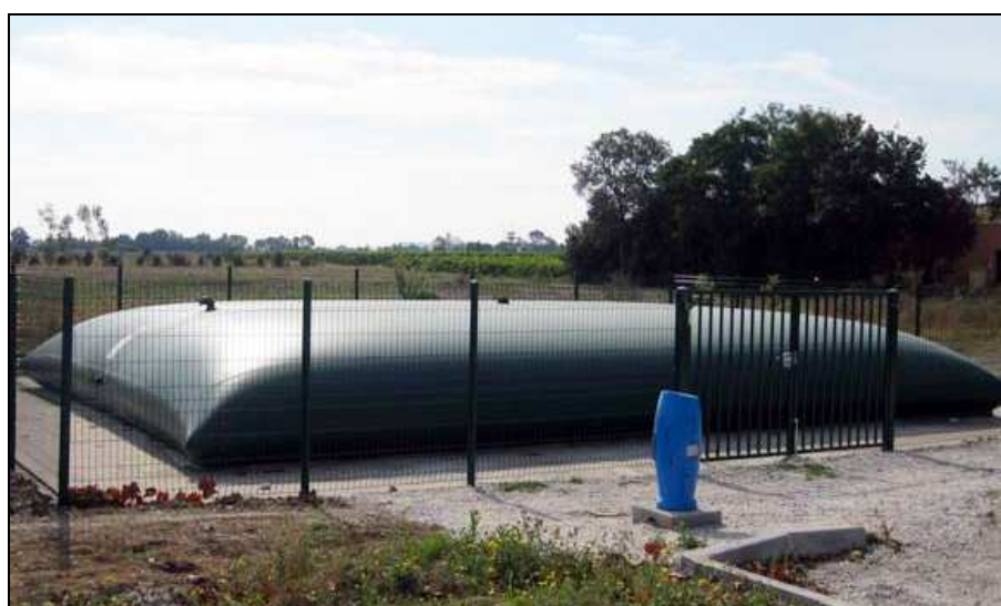
Photo d'une réserve incendie souple
