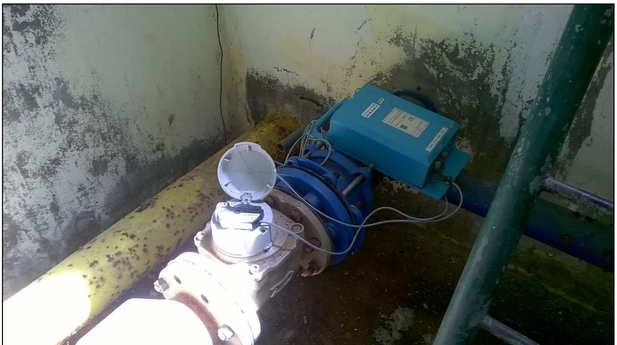
Système d'enregistrement installé dans le réservoir
